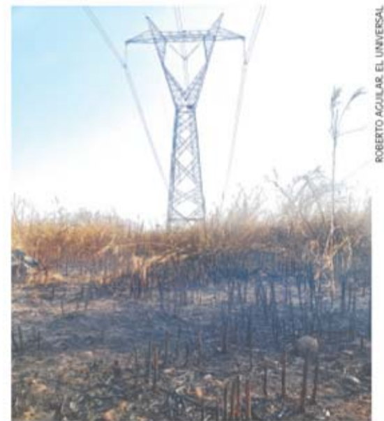
La estructura de las torres de transmisión no muestra signos de daño por fuego.
