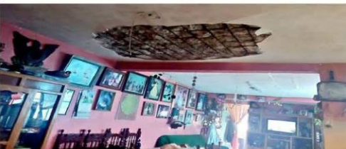
■ Vecinos reportan grietas y desprendimientos en sus casas.
