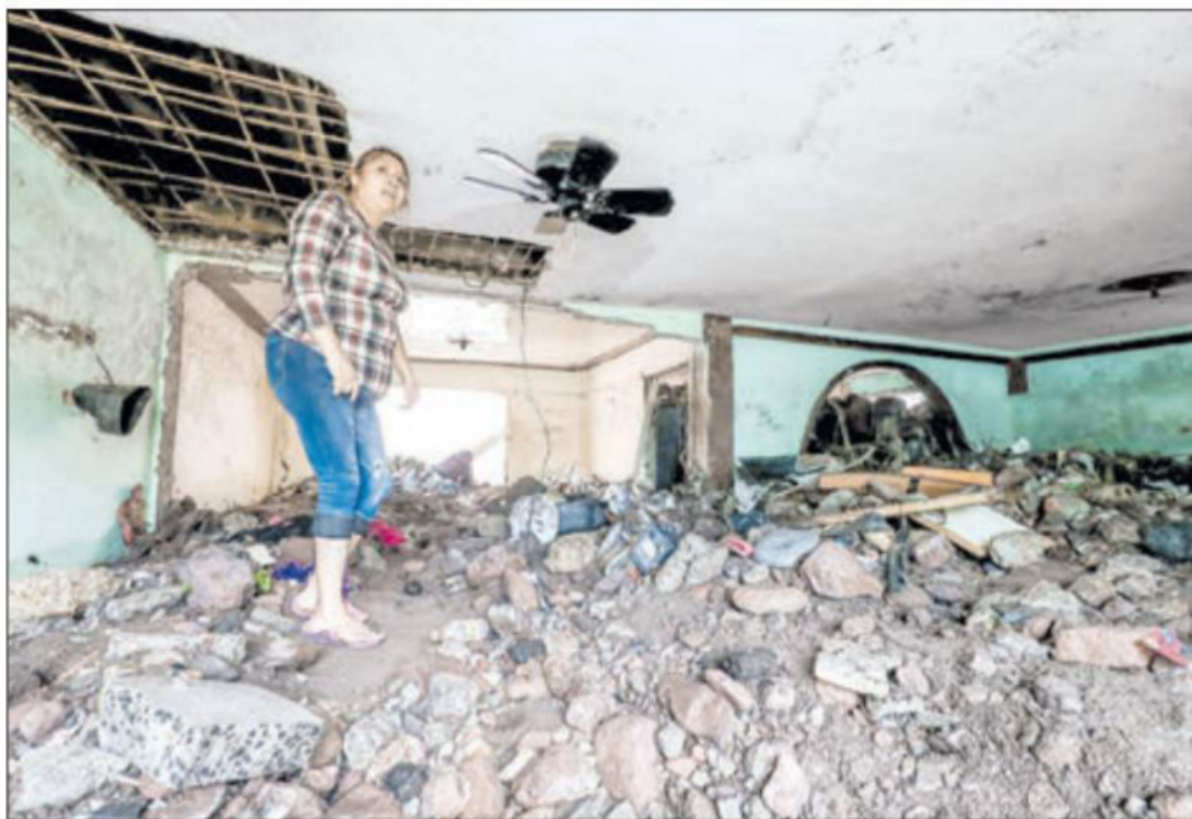
▲ Una vivienda de la colonia La Esperanza, en Ecatepec, quedó repleta de piedras y todo al venirse abajo uno de los muros por el torrente de agua que provocó la tromba del pasado lunes, a la cual se sumaron
