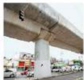
Obra defectuosa. ESPECIAL
