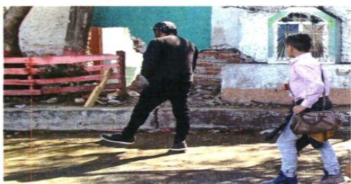
Un agujero de gran tamaño se observa en una barda del cementerio de San Nicolás Tolentino, en Iztapalapa.
