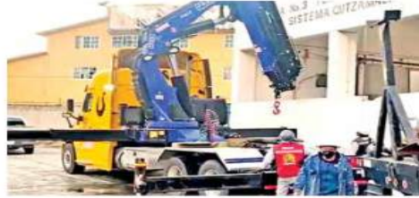
Trabajadores de la Conagua iniciaron ayer las reparaciones. Foto: Especial
