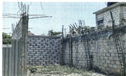
■ En Jotutla, Morelos, aún hay viviendas que se quedaron a la espera de apoyos tras el sismo de 7.1 grados el 19S de 2017.
