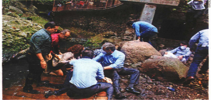
Cuernavaca.— El alcalde José Luis Urióstegui y 20 personas de su comitiva resultaron lesionados por el desplome del puente colgante en el Paseo Ribereño. La estructura fue rehabilitada el año pasado con 20 mil pesos, al quedar fuera del presupuesto para mejoras. | ESTADOS | A18
