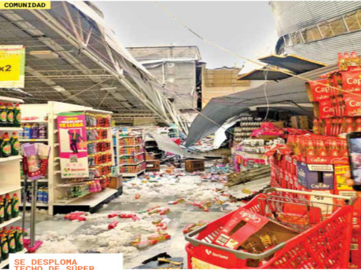
SE DESPLOMA TECHO DE SÚPER
