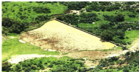
La mayoría de las presas en Ecatepec, que contienen los torrentes que bajan de la Sierra, están en malas condiciones.
