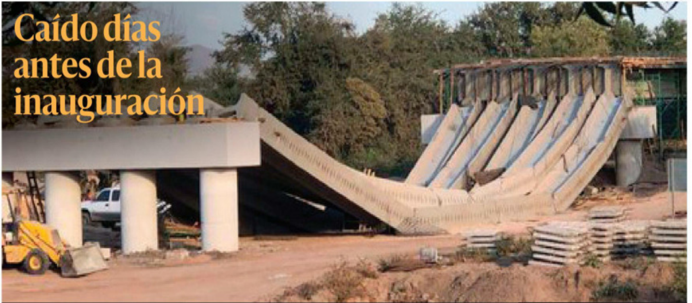
El puente El Quelite, en Sinaloa, colapsó a un mes de la fecha en que debía ser entregado para su inauguración. Las autoridades dijeron que el desplome se debió a una "mala maniobra en la construcción". PAG 8
