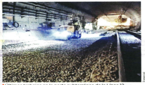
Últimos trabajos en la parte subterránea de la Línea 12 del Metro antes de iniciar los 15 días de pruebas.
