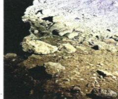
El socavón y parte de los daños que la humedad ha provocado en la Ciudad del Bienestar, proyecto insignia de Claudia Sheinbaum en la CDMX.
