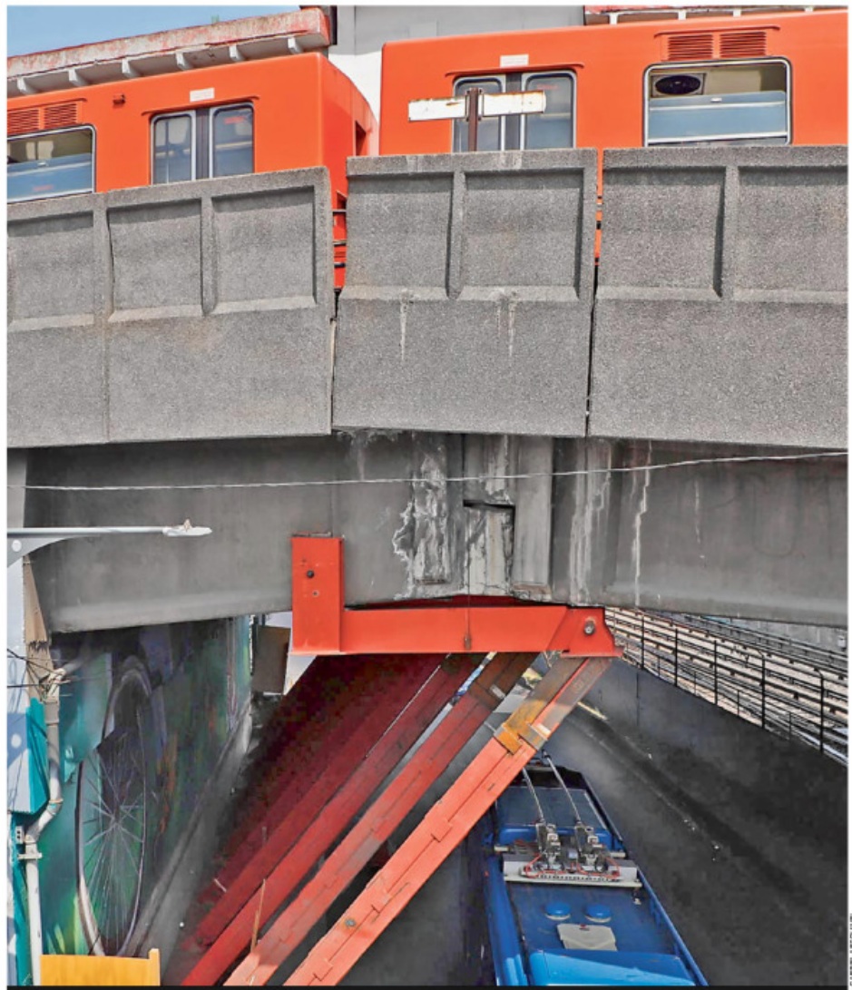
LUPA EN PANTITLÁN. La jefa de Gobierno enviará a nuevos especialistas para inspeccionar un tramo elevado de la Línea 9, donde colocaron soportes para contrarrestar los hundimientos y amortiguar el movimiento CDMX P. 7
