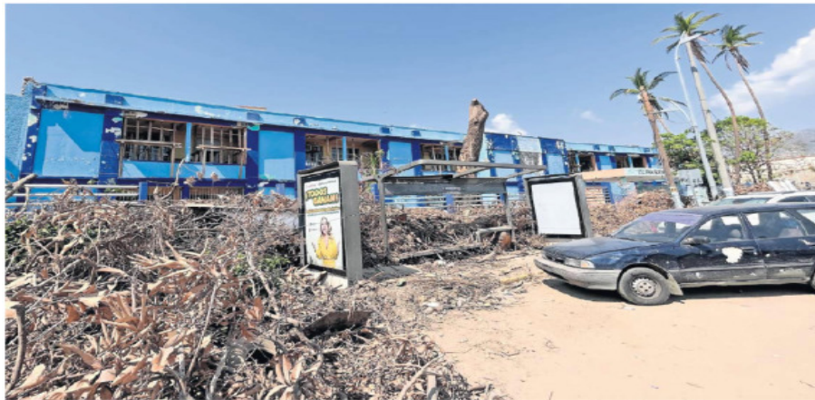
Planteles públicos de educación permanecen cerrados y con daños; los escombros y basura no han sido recogidos.
