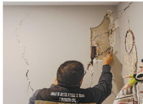
Personal de Protección Civil revisa los daños por los microsismos en el conjunto habitacional Los Patios, en Mixcoac.
