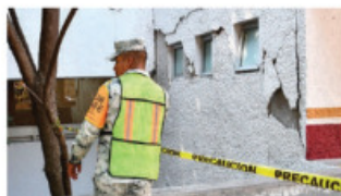
DAÑOS en un hospital en Chilpancingo.
