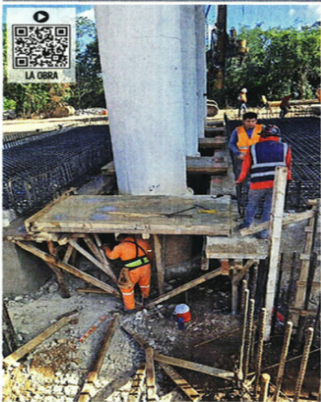
Trabajos de apuntalamiento intentan frenar el hundimiento de pilotes del Tren Maya.
